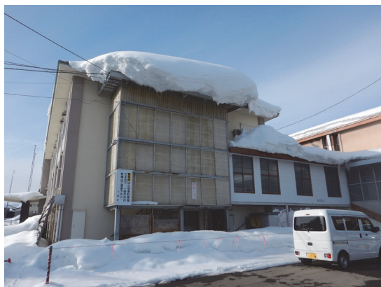
写真1 旧町役場の屋根に生じた巨大な雪庇
